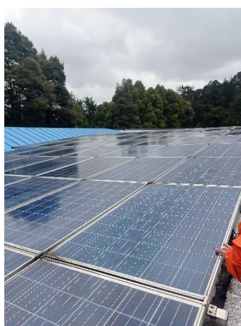
Figura 2: Paneles solares del parqueadero I
