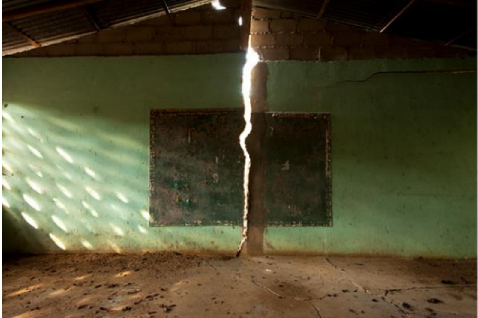
Ilustración 7 Silencio con grieta 2011 - Las Palmas, Bolívar, Colombia
